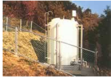
広島町小手島中継水槽
